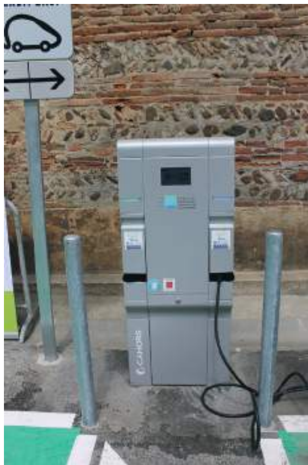
Borne de recharge électrique - source SDEHG
